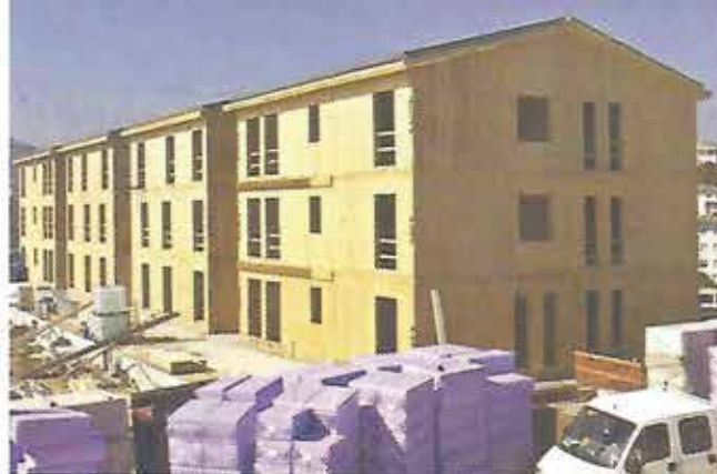
Case all'Aquila. Nella ricostruzione dopo il terremoto, il legno è stato protagonista, offrendo soluzioni abitative realizzate in tempi ristretti, confortevoli ed economiche
